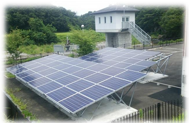
矢吹原発電所 3 (隈戸)
